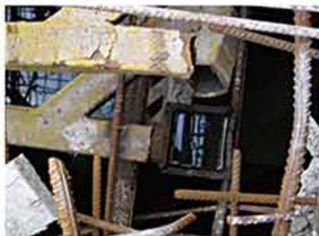
图3 1号主弦杆上断口
