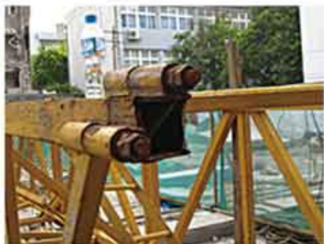
图2 1号主弦杆上断口
