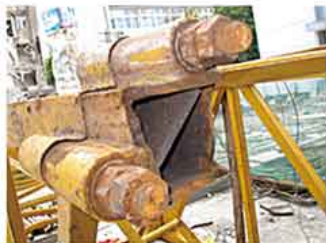
图1 1号主弦杆上断口
