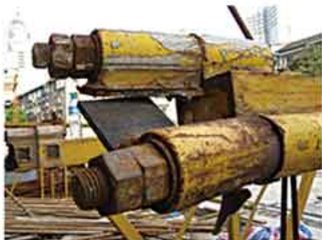
图 5 2 号主弦杆断裂口
