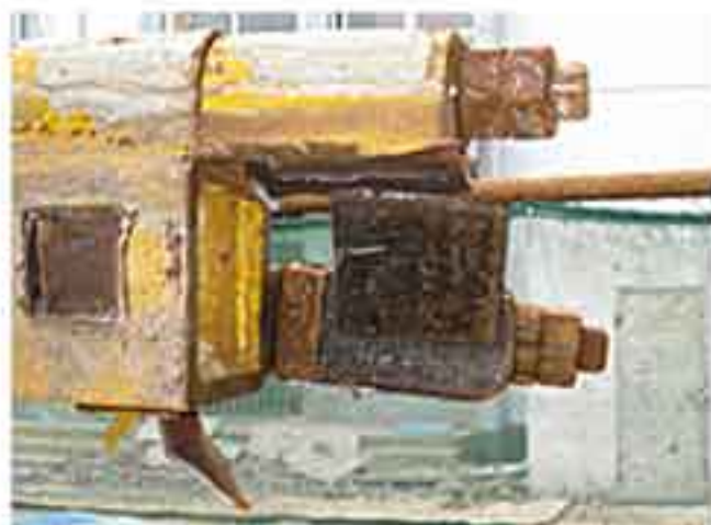
图 6 2 号主弦杆断裂口
