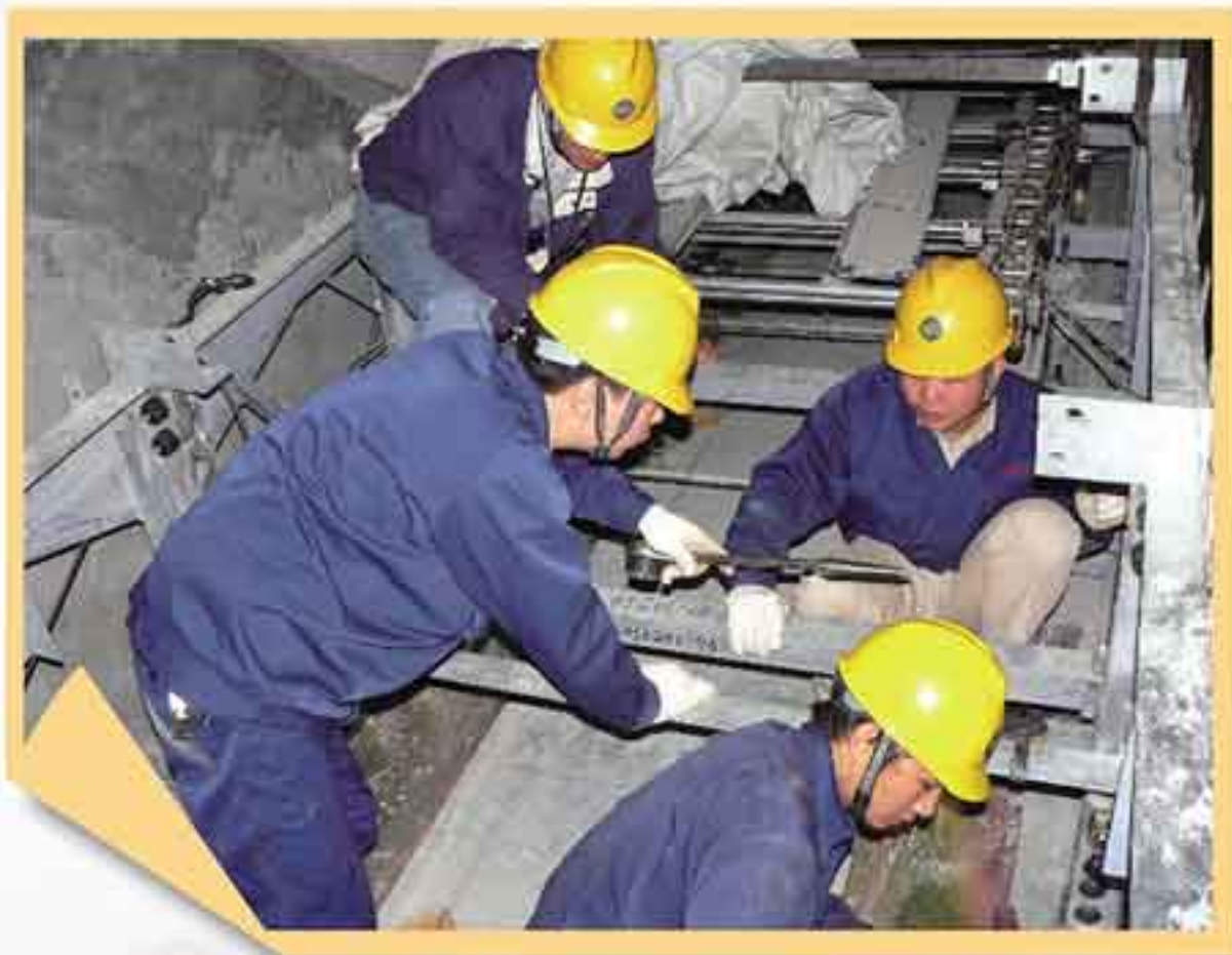
营业工程统括总部技术人员对安装小组进行现场技术指导
